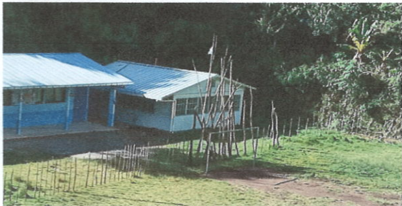
Foto 5: La mayoría de los postes se encuentran en estado de putrefacción
