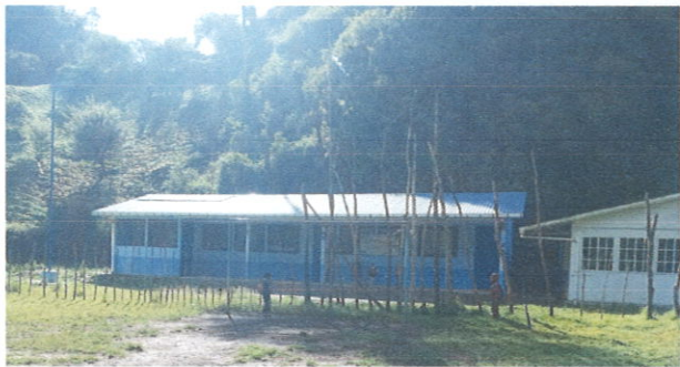
Foto 4: El perímetro se encuentra en mal estado y puede ocasionar accidentes para los niños de preprimaria.
