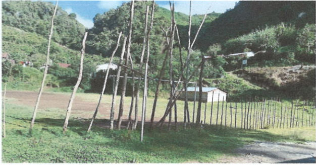
Foto 1: El muro perimetral está hecho de postes, inadecuado para el perímetro.
